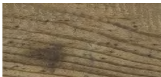
Stockflecken und leichter Schimmelbefall
