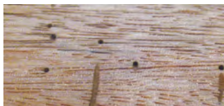
„Pinholes“ bei überseeischen Harthölzern
