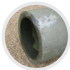
Rohre mit beschädigter Oberfläche
