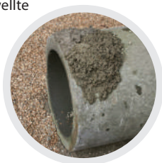
Teilweise oder komplett einbetonierte Rohre
