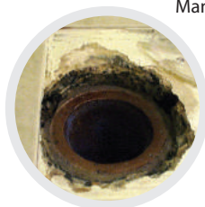
Bündig abgeschnittene Rohre
